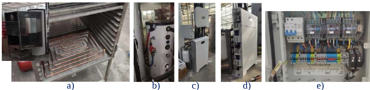
7.8.10. att. Žāvētava a) žāvēšanas spirāle, b) akumulācijas tvertne, c) invertors, d) terminālbloks, e) terminālbloks, skats no iekšienes
