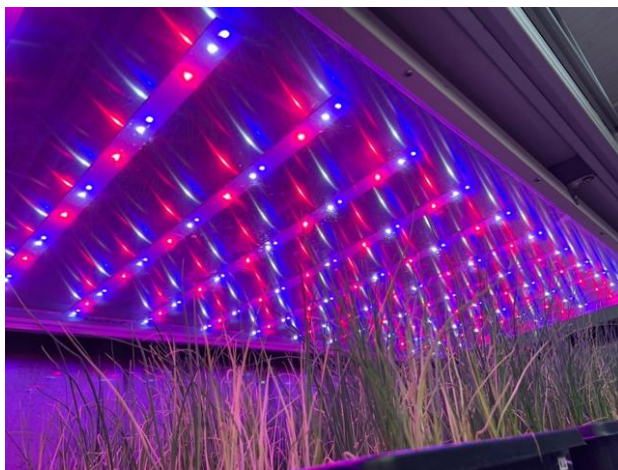
2.5.1. att. Uzstādītie vecā tipa 4DBios ražotāja gaismekļi "Broccoli" konteinerī
